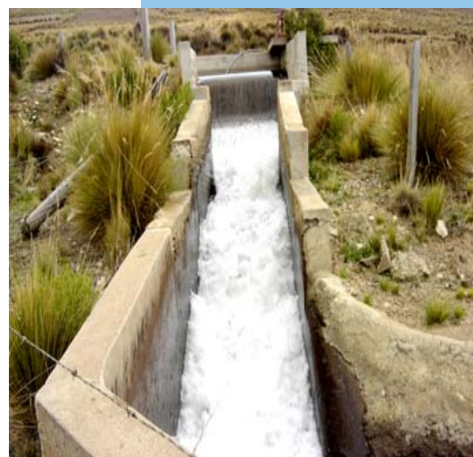
Distribución de agua por canales. Fotografías: CAPEX.
